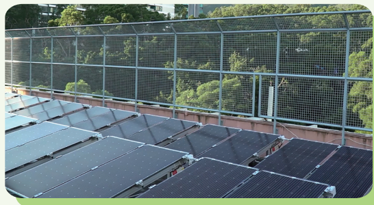
▲ 樂善堂余近卿中學「陽光校園可再生能源教育計劃」- 太陽能光伏板
